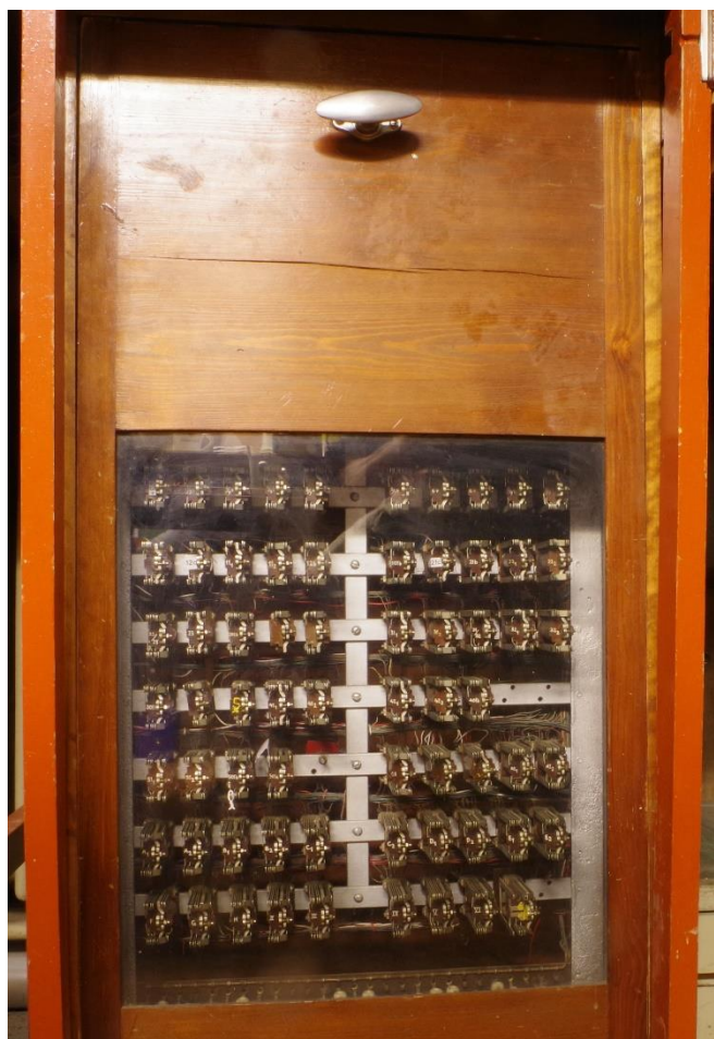
4 - Nø: Relæteknologi fra 1950'erne – relæskab til Borup st. – Foto: J. Bertelsen, DMJK
